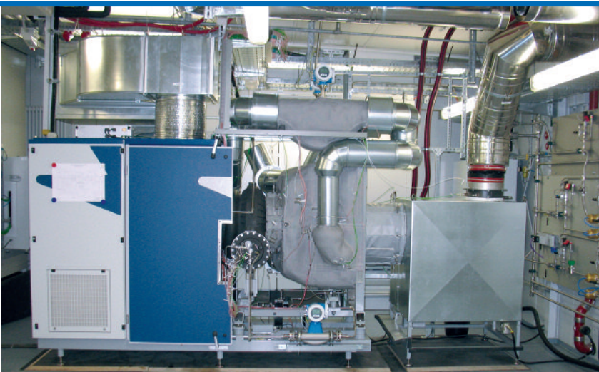
Mikrogasturbinen-Prüfstand im Technikum des Instituts für Verbrennungstechnik – die Mikrogasturbine ist neben der SOFC-Brennstoffzelle die Kernkomponente eines Hybrid-Kraftwerks.
