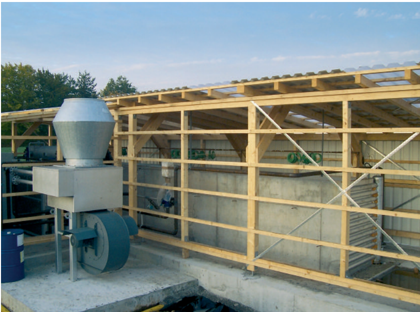
Betonspeichermodul in der Testanlage in Stuttgart.
