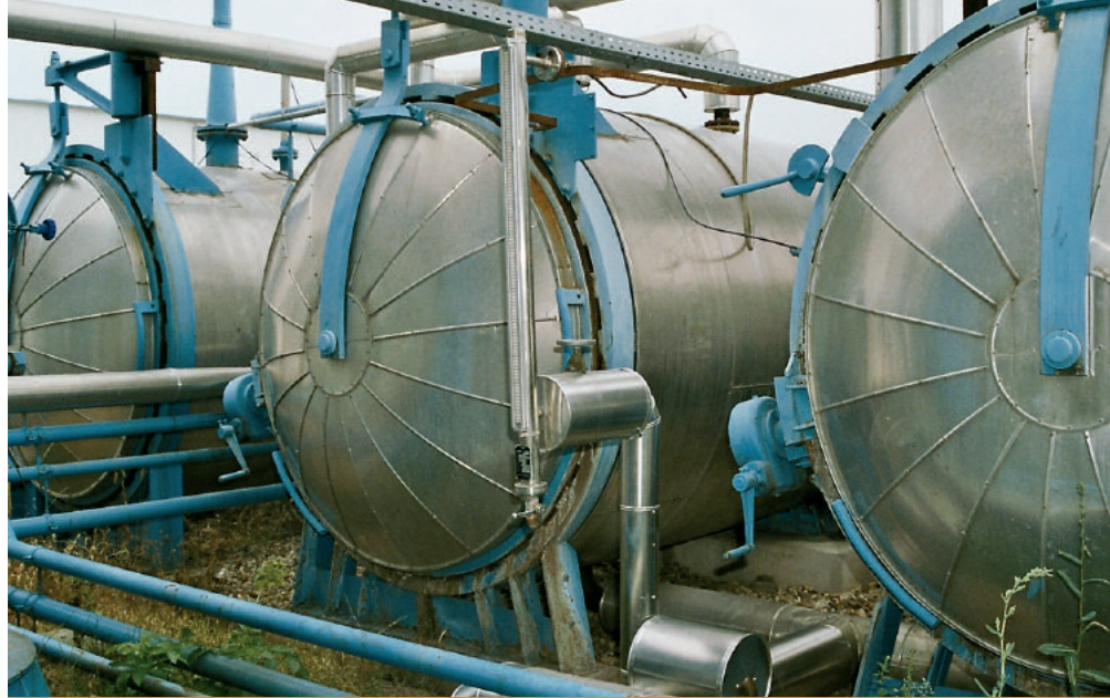
Druckkessel zur Härtung von Baustoffen unter einer Dampfatosphäre.
