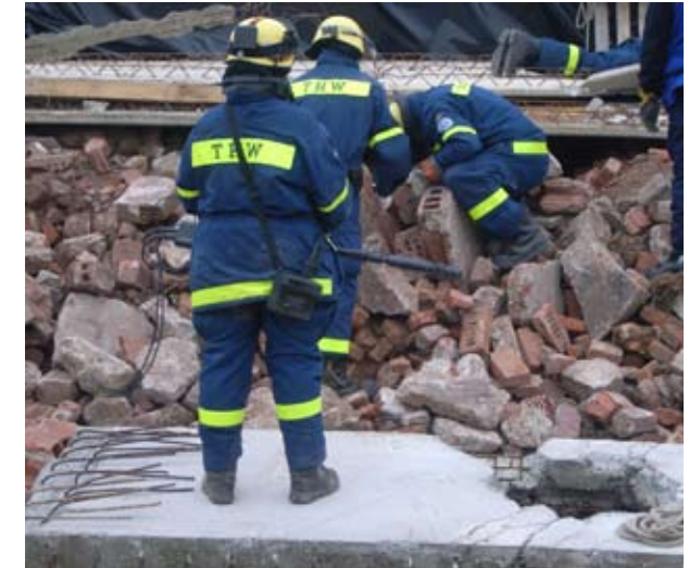
Zur Koordination der Hilfsmaßnahmen müssen Schadensberichte schnellstens zur Leitzentrale gelangen. Das funktioniert am besten über Funk (Satellit oder WLAN-Netze, die vor Ort aufgebaut werden).
