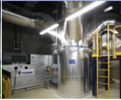
Speicher mit Luftsammler.
