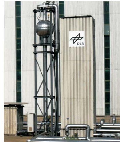
Latentwärmespeicher im Testbetrieb in Carboneras, Spanien (14 t NaNO 3 , Phasenwechsel bei 305 °C)
