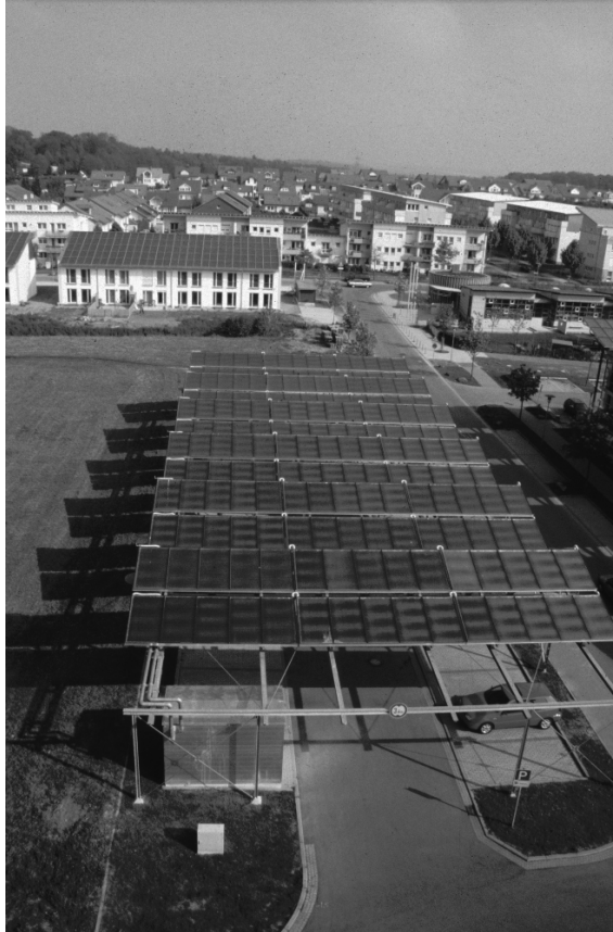
Abbildung 15: Kollektoren als Parkplatzüberdachung in Amorbach
