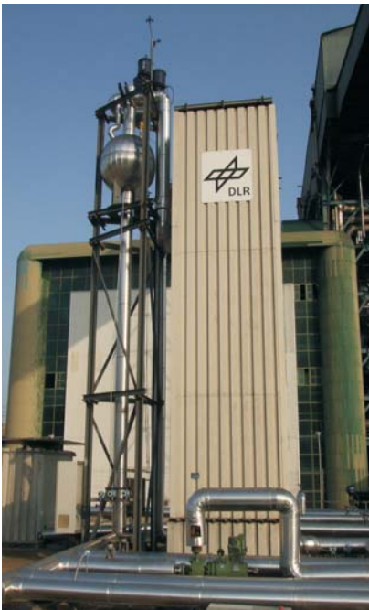
Latentwärmespeicher im Testbetrieb in Carboneras, Spanien (14 t NaNO 3 , Phasenwechsel bei 305 °C)
