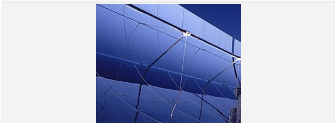
Parabolrinnenanlage auf der Plataforma Solar de Almería/Spanien
