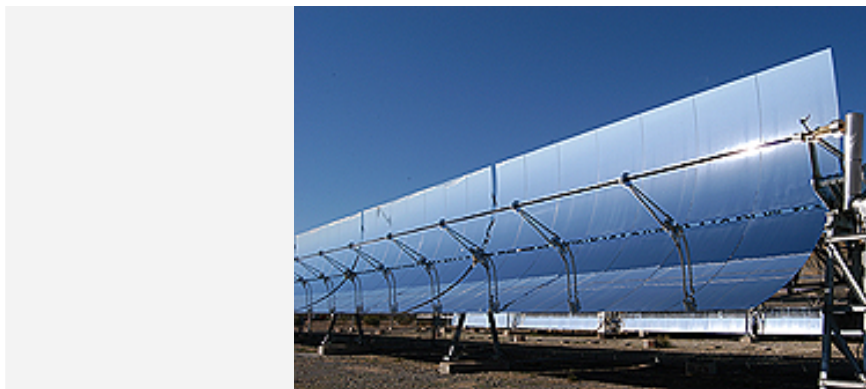
Die Sonne nutzen: Parabolrinnenanlage in Almería (Südspanien)
