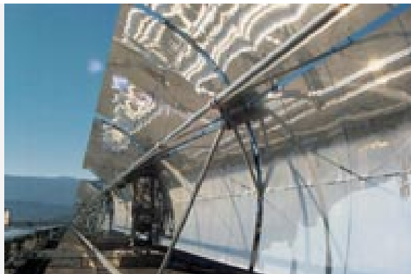
Parabolrinnenanlage auf der Plataforma Solar de Almería
