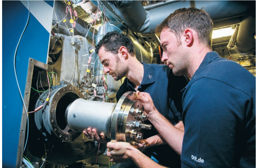
Einbau des Holzgas-FLOX®-Brennkammersystems in die Mikrogasturbine Turbec T100
