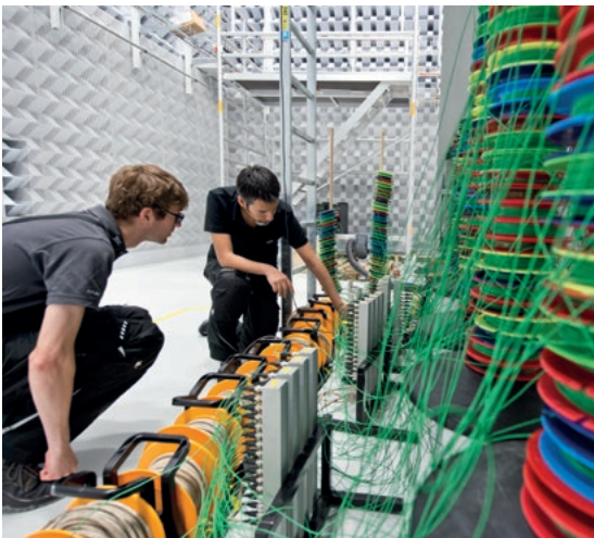
Die Kabelführung für 200 Sensoren muss so organisiert sein, dass Fehler und Defekte möglichst schnell behoben werden können
