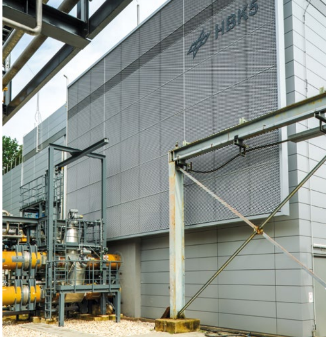
Der Hochdruck-Brennkammerprüfstand HBK-5 des DLR in Köln wurde im November 2014 nach nur einjähriger Bauzeit in Betrieb genommen
