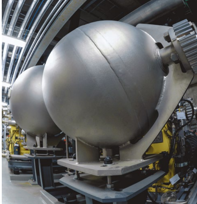
Große Pufferbehälter dienen dazu, Druckschwankungen im Kühlwassersystem des Prüfstands auszugleichen
