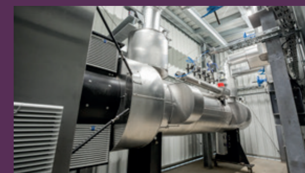
Der Elektrokessel des Hastedter Hybridregelkraftwerks funktioniert wie ein überdimensionaler Tauchsieder und wandelt überschüssigen Strom in Wärme um. Bei Bedarf wird diese für das Bremer Fernwärmenetz bereitgestellt.
