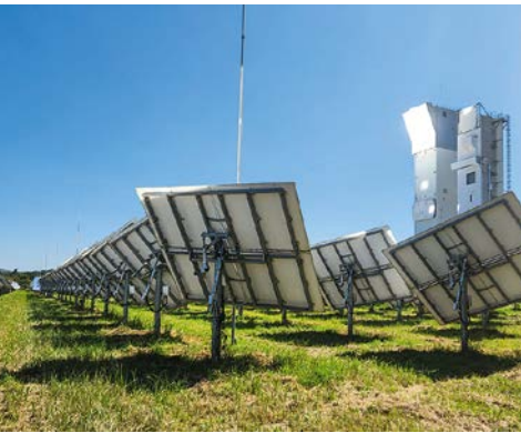
Solartürme des DLR in Jülich
