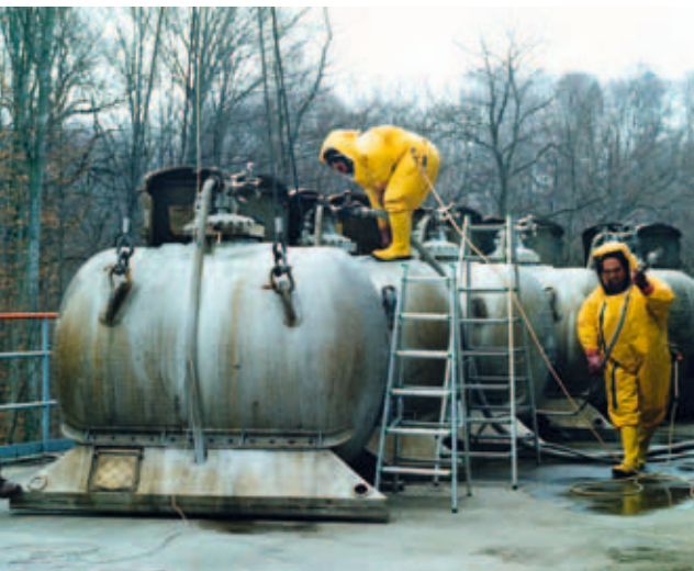
Bild oben links: Für die Lagerung der hypergolen Treibstoffe wurden spezielle Tanklager errichtet. Nur in Schutzanzügen durften die Mitarbeiter mit den Treibstoffen arbeiten.
