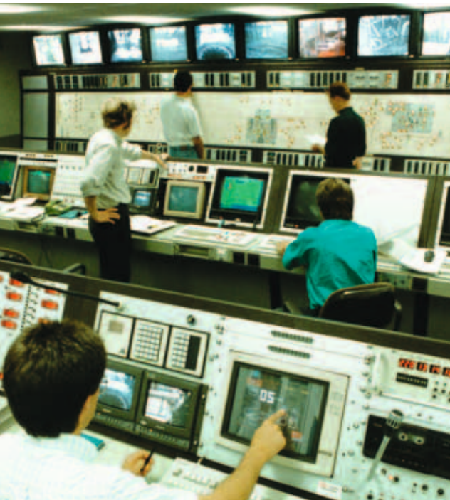
Kontrollraum M8 für den Testbetrieb am Prüfstand P5.
