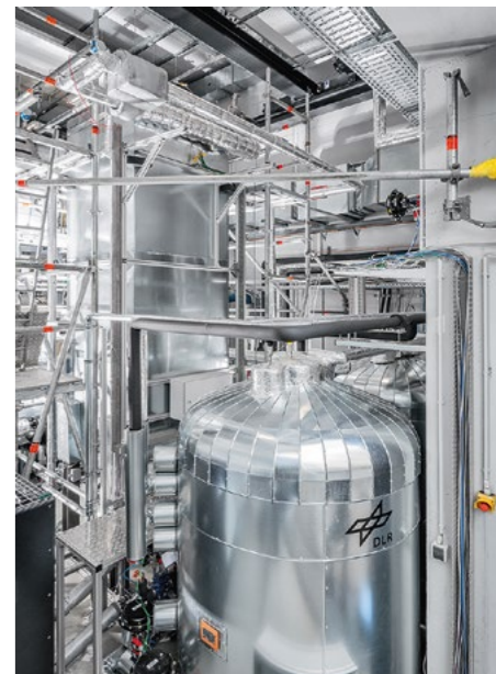
Carnot-Batterien speichern Strom in Form von Wärme. Das DLR und das CHESTER-Konsortium (Compressed Heat Energy Storage for Energy from Renewable Sources) bauten die weltweit erste Carnot-Batterie auf Basis von Dampfkraft-Prozessen.
