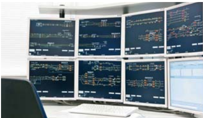
Fahrdienstleiterarbeitsplatz Traffic controller's workplace
