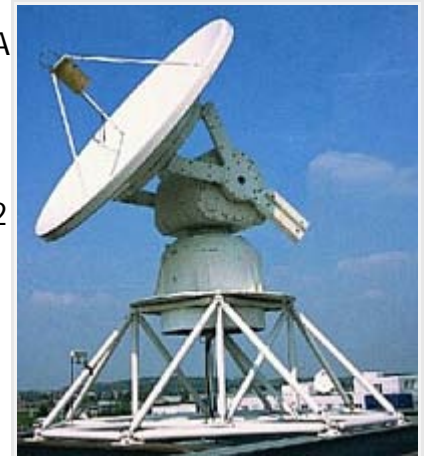
NOAA-Antenne auf dem Dach des DFD-Gebäudes
