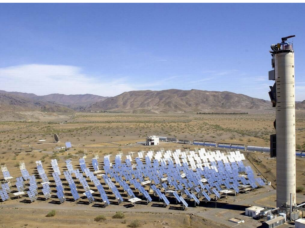
Das Solarkraftwerk im spanischen Almeria ist eine große Testanlage, an der auch das DLR mitwirkt.
