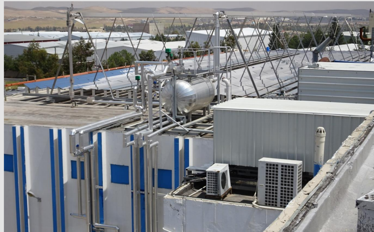
Solare Prozessdampfanlage bei RAM Pharma Amman, Jordanien, auf dem Dach mit 2000l Dampftrommel
