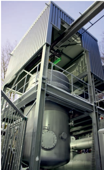
Seitenansicht des Speicherbehälter
