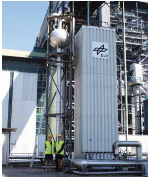
Abb. 1 Mit den 14 Tonnen Natriumnitratsalz dieses weltgrößten Latentwärmespeichers lassen sich 700 kWh thermischer Energie bei 300°C speichern. Der Speicher wurde in ein Dampfkraftwerk im spanischen Carboneras integriert und absolvierte dort erfolgreich hundert Zyklen. Solche Konzepte eignen sich besonders für solarthermische Kraftwerke mit Direktverdampfung.
